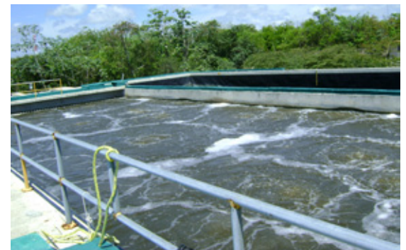
Planta de tratamiento Autor: CEA
