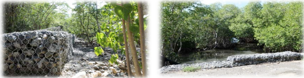
Fotografía 50 y 51. Sistema de gaviones para el control de erosión en la vereda larga del
