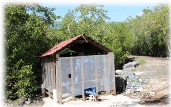
Fotografía 11. Bomba tipo turbinada ubicada en el dique oeste del RVSILAM
