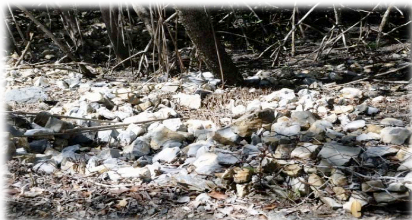
Fotografía 52. La degradación de los gaviones en la vereda larga de
