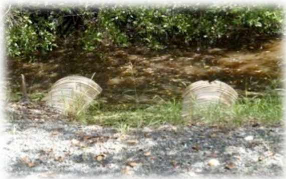
Fotografía 6. Tubería de desagüe para controlar el nivel de agua del embalse
